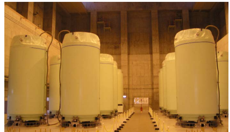
日本原子力発電（株）東海第二発電所での乾式貯蔵
