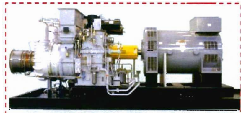
ガスタービン発電設備
